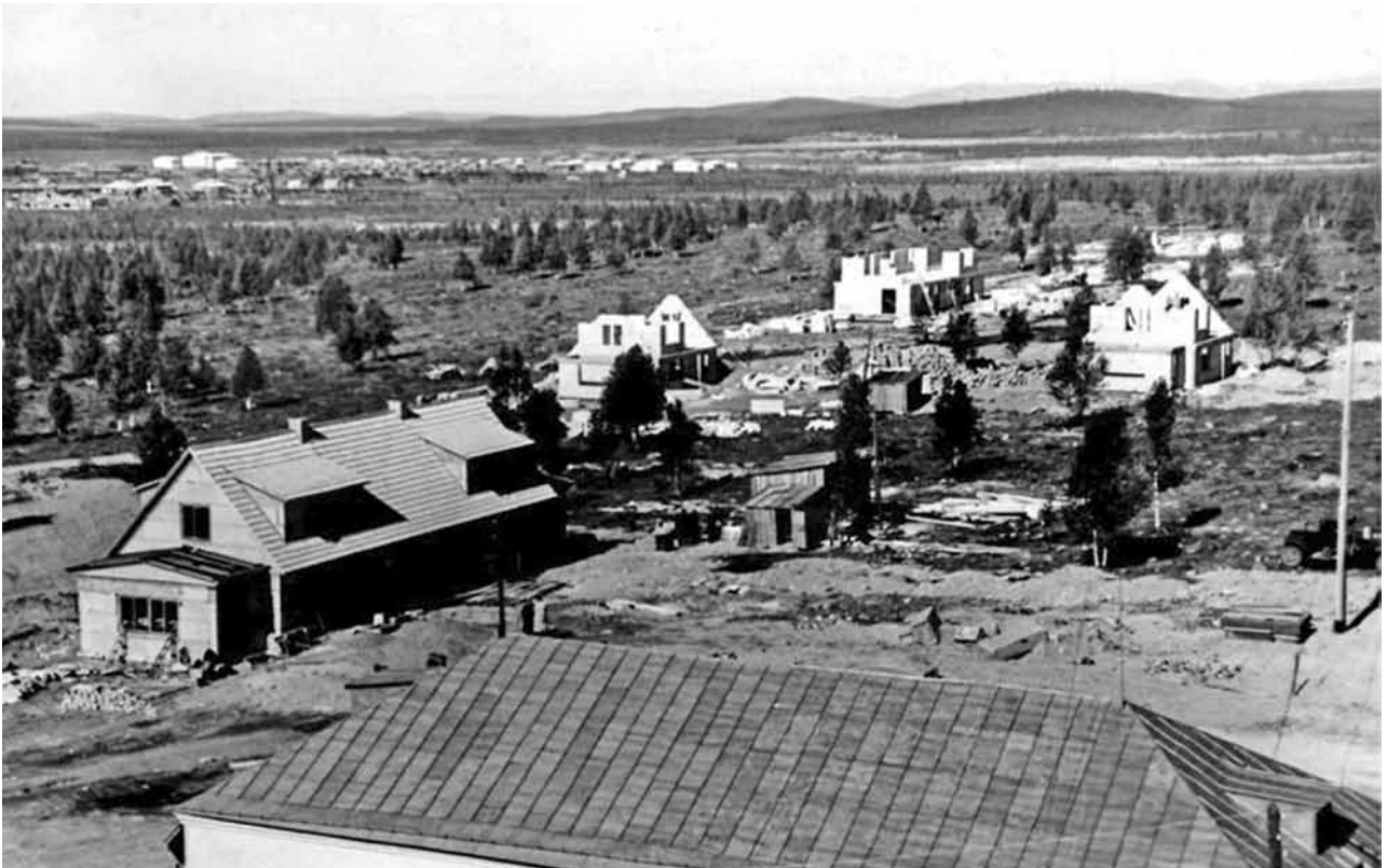
Строительство силикальцитных домиков Академгородка, лето 1959 г. Construction of silicalcite cottages of Akademgorodok, summer 1959.
