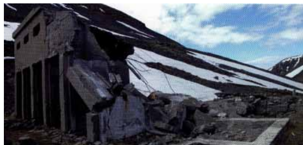
Рис. 4. Фидерная подстанция, разрушенная водоснежным потоком в долине р. Гакмана в мае 1995 г. [13]. Fig. 4. Feeder substation destroyed by water and snow flow in Hakman River Valley in May, 1995. [13].
